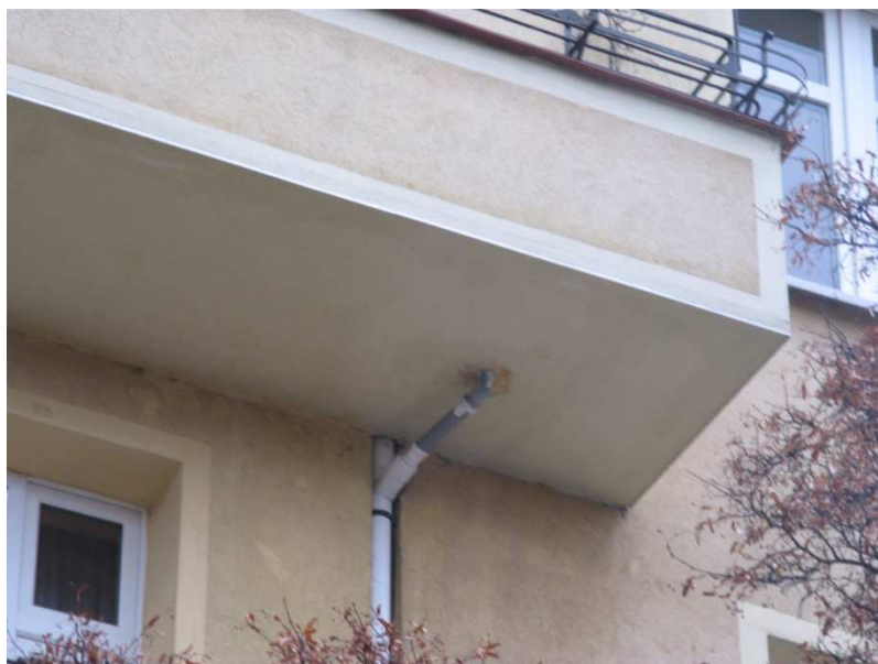
Fot. 3.15. Rura wpustowa przy odwodnieniu wewnętrznym balkonu z pełną balustradą. Poznań, ul. Niegolewskich [dokumentacja własna]
