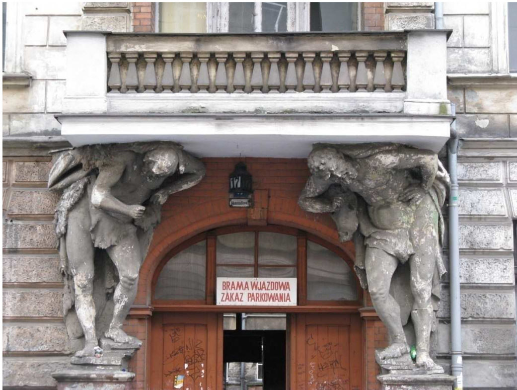
Fot. 3.20. Okazały portal z postaciami atlantów podtrzymującymi balkon nad wejściem do zabytkowej kamienicy z 1895 roku. Poznań, ul. Kanałowa [dokumentacja własna]
